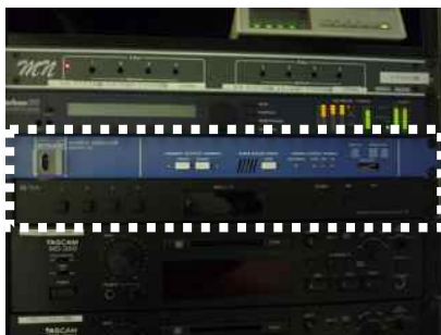
← 緊急割込装置と無音検知器
